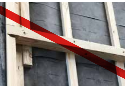
Ventilation arrière fermée
